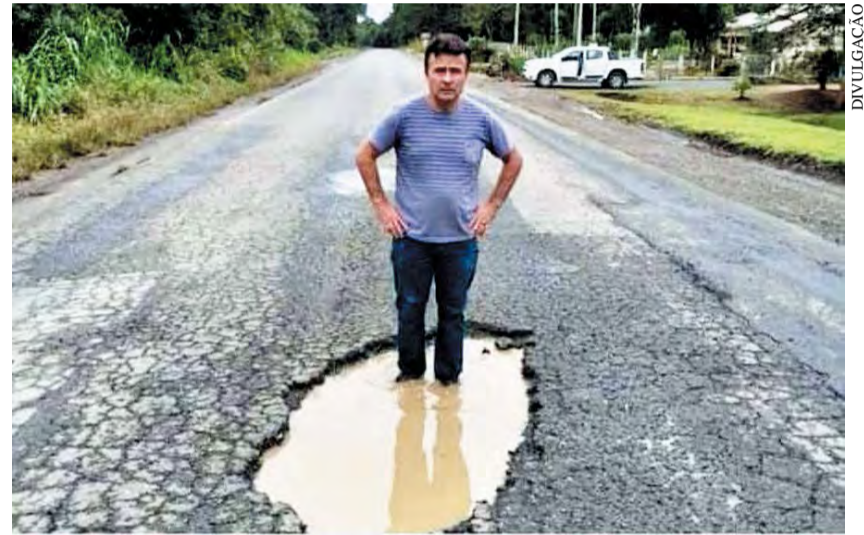
Um dos coordenadores do movimento popular de Major Vieira, Pró Restauração da SC 477, Sérgio Lezan, posa para a foto, mostrando a "cratera" no meio da pista da rodovia
