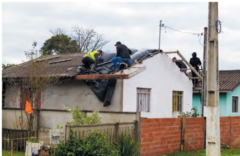
Três Barras sofreu com destelhamentos e quedas de energia elétrica
