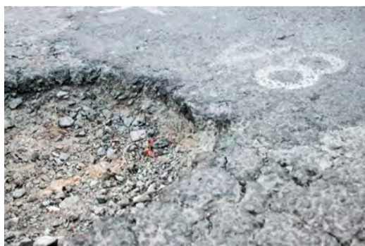
Nova “operação tapa-buracos” deve ser realizada em junho para amenizar o problema
