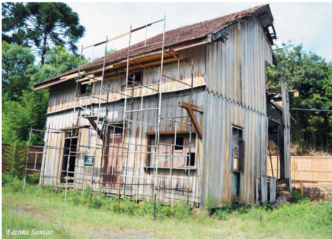
O restaurante encontra-se em condições precárias
