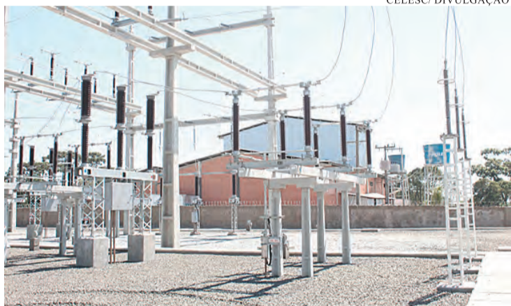
Celesc inaugura subestação em Papanduva. Obra de R$ 30 milhões fornece energia elétrica para Papanduva, Santa Terezinha, Monte Castelo, Major Vieira e Itaiópolis.
