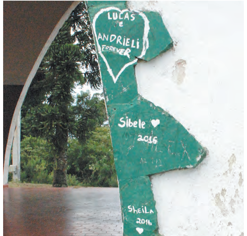
Nomes e desenhos foram pintados nas paredes externas e internas da capela
