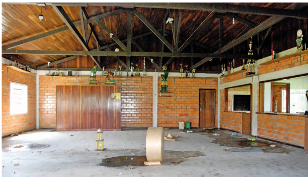
A sede da associação não está em funcionamento devido às condições do espaço
