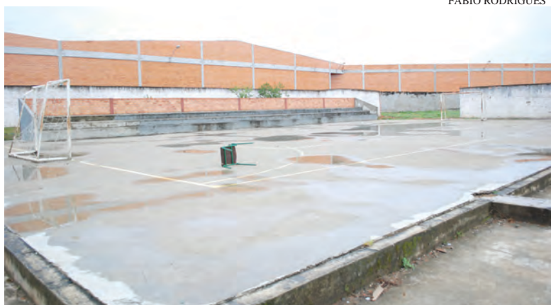
Quadra fica sem condições de uso em dias de chuva
