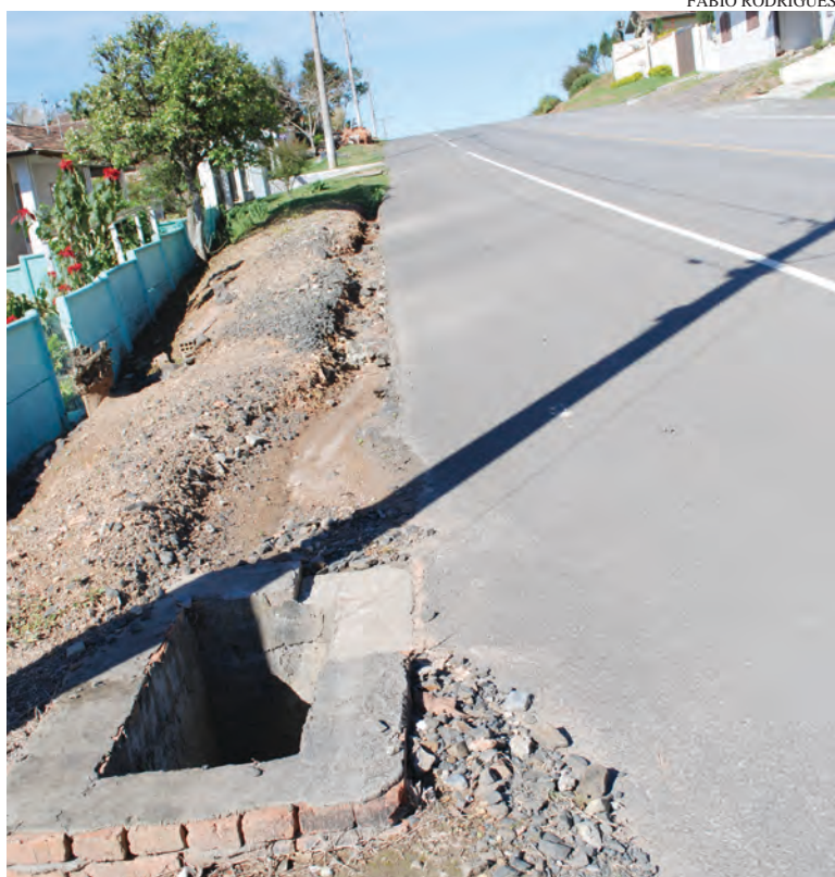
Rua Emílio Scholtz não tem meio-fio e bocas-de-lobo estão abertas
