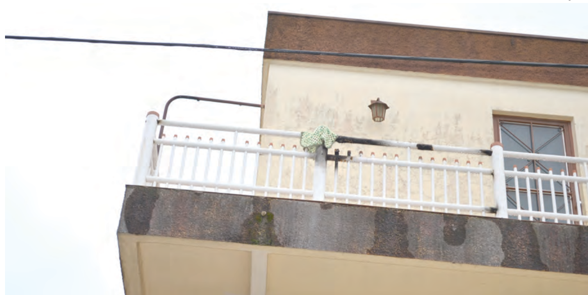
Sacada do prédio em Três Barras, onde aconteceu o acidente
