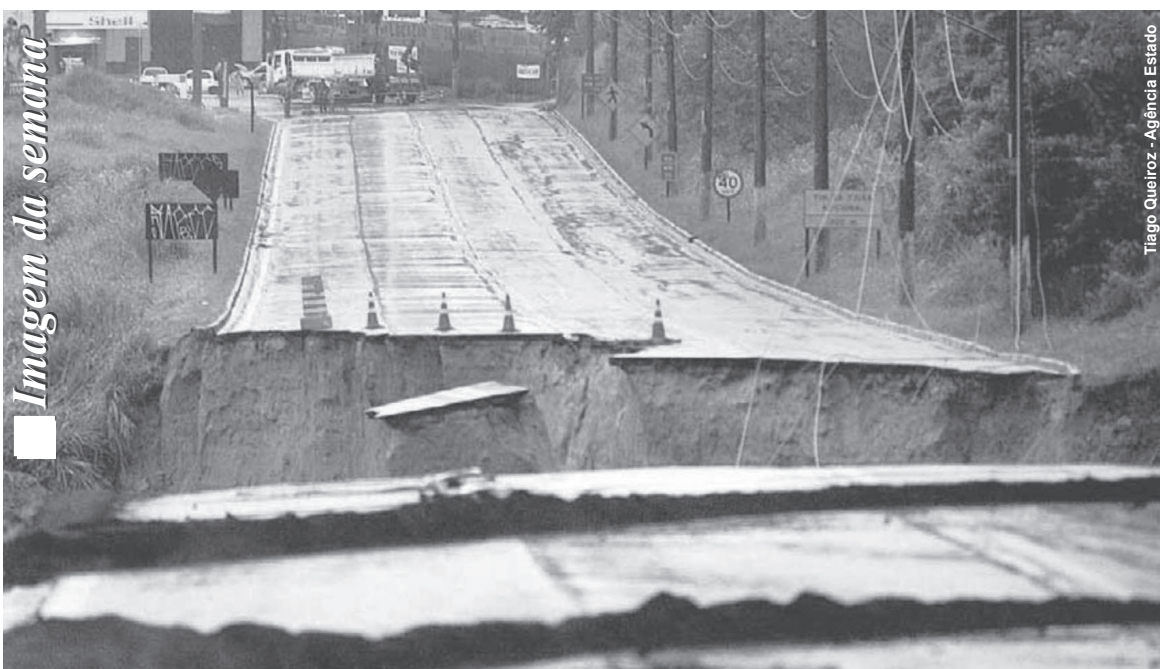
CRATERA: Asfalto cedeu e engoliu caminhonete no acesso da Castelo Branco a Itapevi, durante chuva em SP
