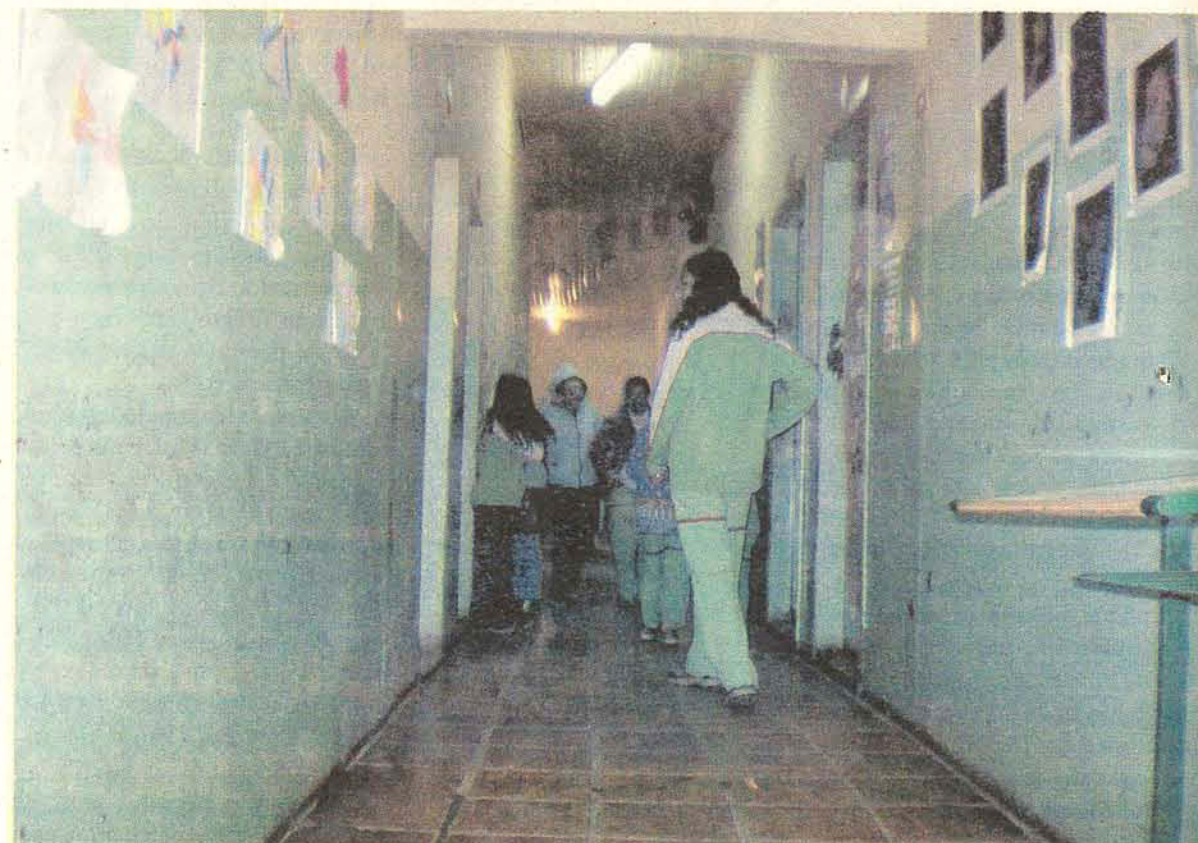
Escola de Educação Básica Rodolfo Zipperer: desenhos que até segunda-feira, 2 disfarçavam a sujeira das paredes, foram enegrecidos junto com as paredes depois do incêndio da madrugada de terça-feira, 3
