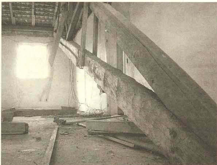
Queda da base de sustentação do telhado chegou a afundar o assoalho
