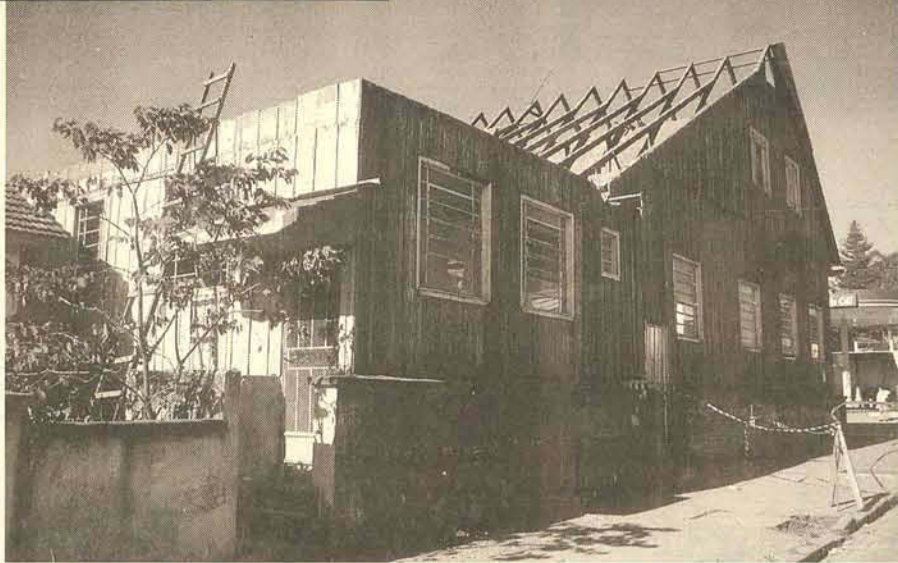
Canoinhas está perdendo um de seus mais antigos edifícios. Construída em madeira, a propriedade da família Seleme na esquina da Cel. Albuquerque com a Eugênio de Souza está sendo desmanchada para dar lugar a um posto de combustíveis
