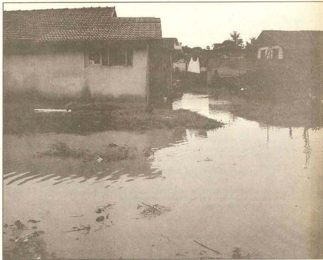
A água da chuva transbordou da vala e invadiu a cozinha de Irma
