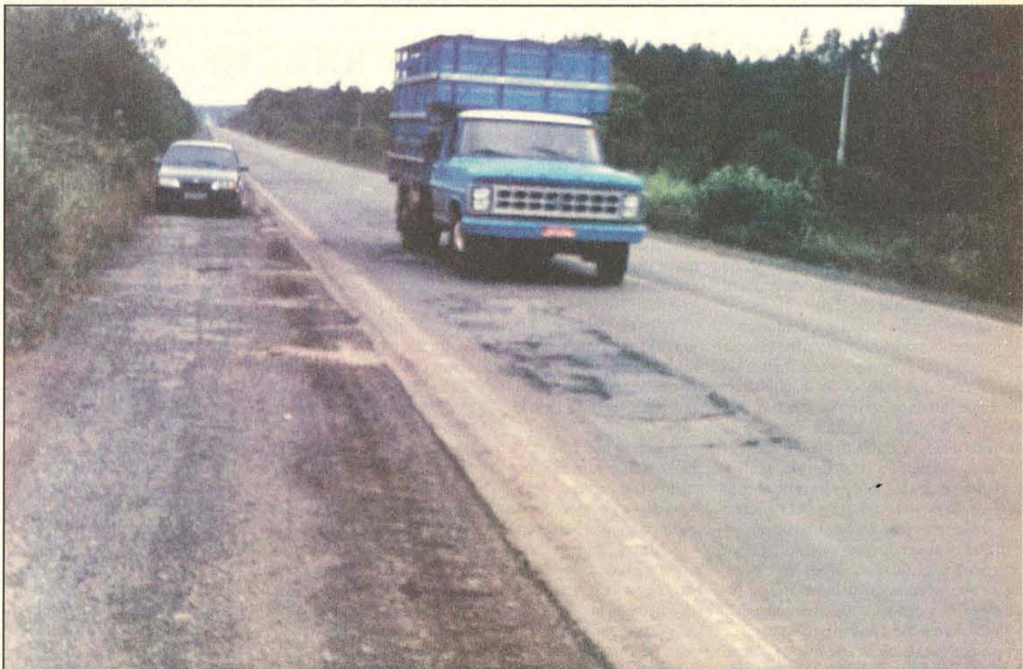
Situação precária da rodovia
