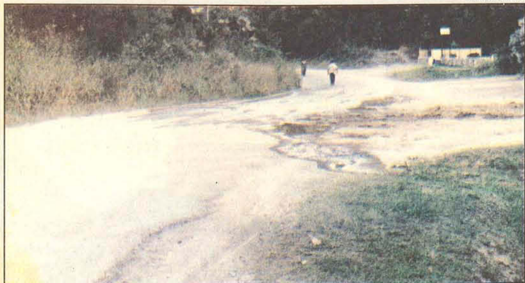
Buracos e mato tomam conta da estrada
