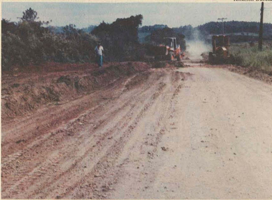
Engenheiro do DER nega que as obras estejam desaceleradas por falta de pagamento
