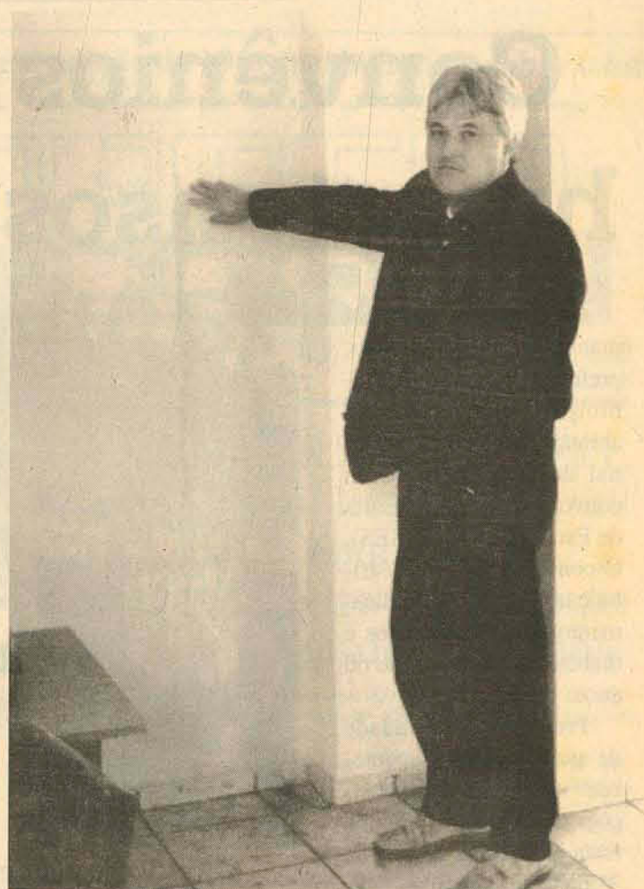
□ Prefeito mostra que rachaduras tomam conta das paredes
