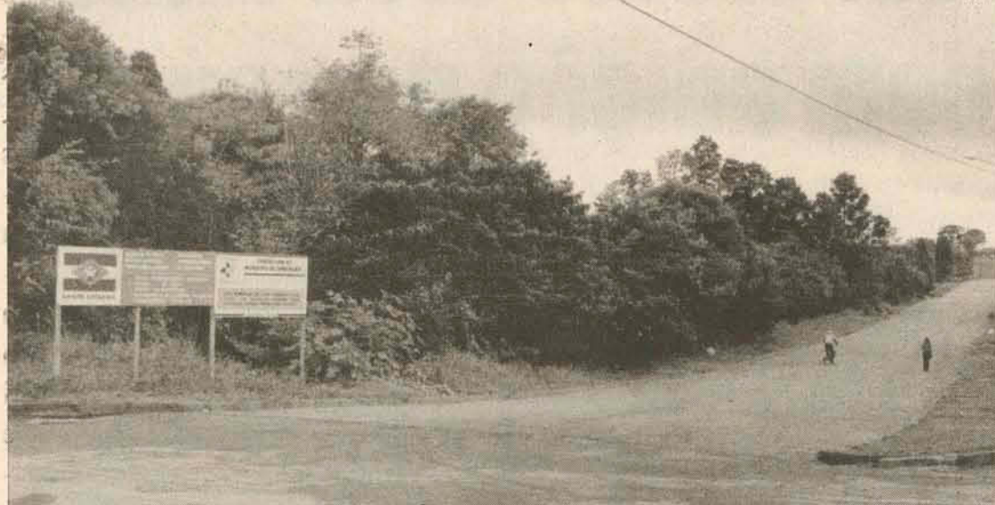
A rua Roberto Ennes já apresenta problemas na pavimentação que ainda não está concluída, em alguns locais as lajotas afundaram
