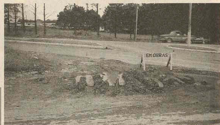
O asfalto na rua 3 de maio não ficou inteiro por muito tempo
