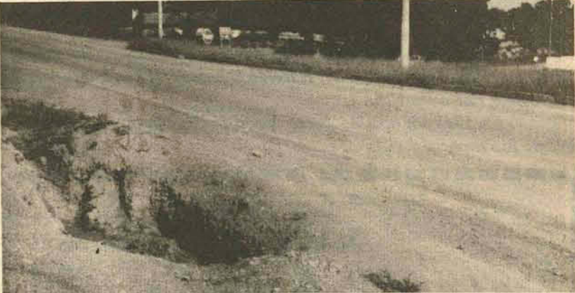
A cratera aberta no acostamento da pista, coloca em risco todos
