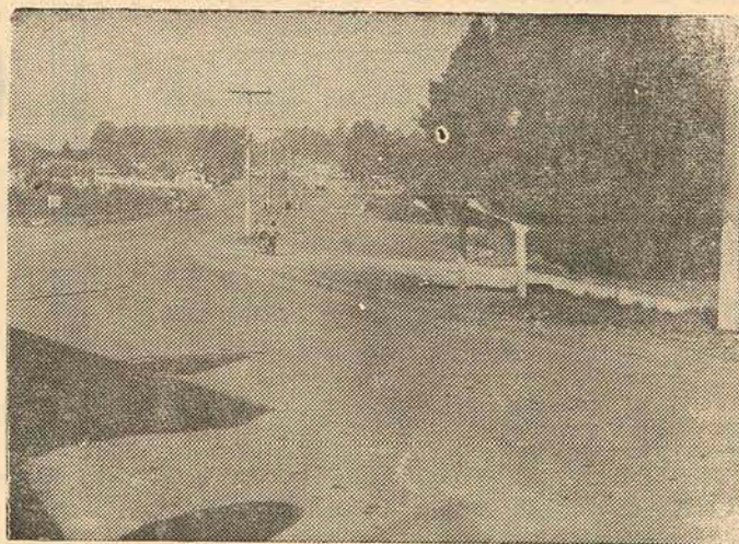
Aterro ponte Km 02 — futuro acesso a Residência II dando continuação da avenida, viabilizando trânsito segunda pista.
