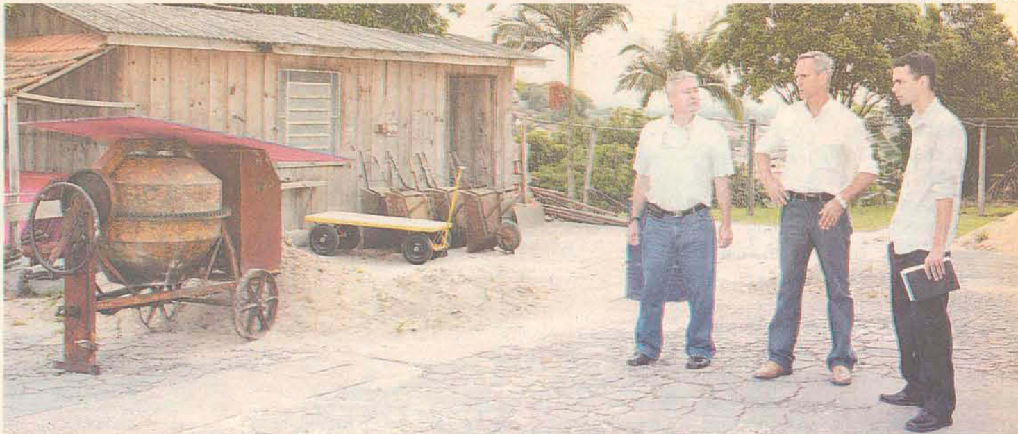
Celso Oliveira observa as primeiras movimentações nas obras junto com o diretor do hospital e o responsável da empresa Sul Brasil
