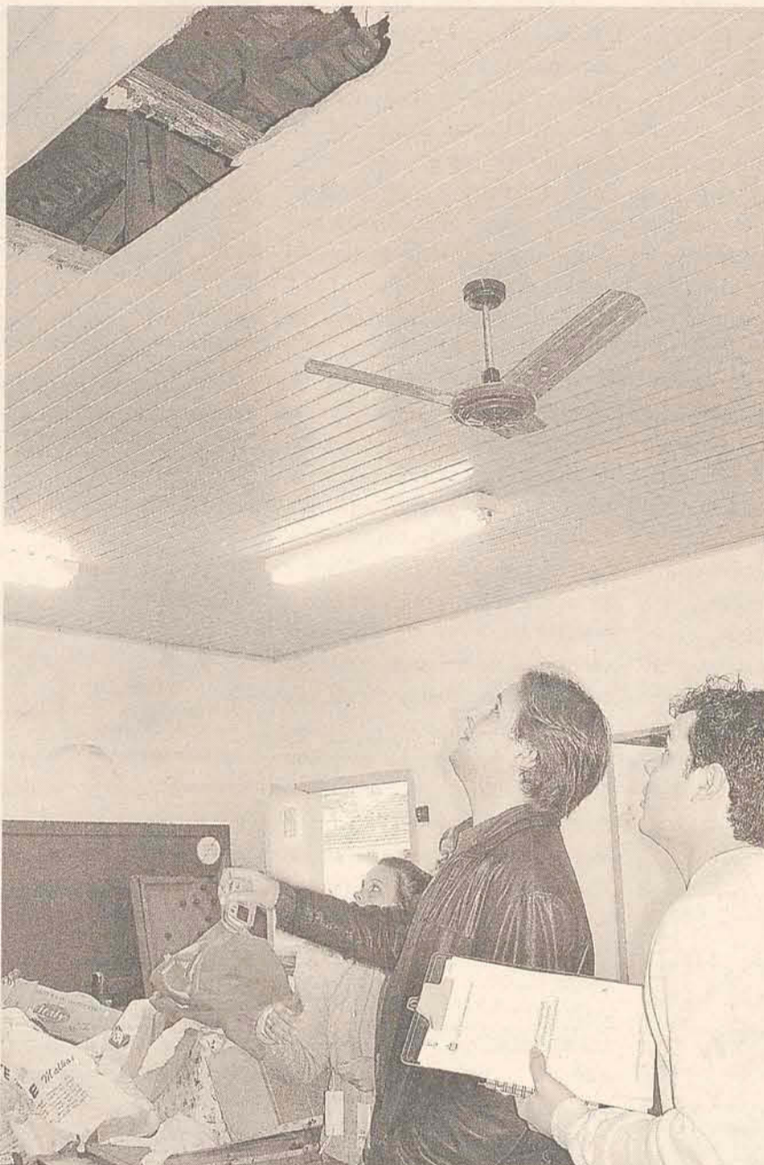
Arquitetos comprovaram o estado crítico que se encontra a escola.
