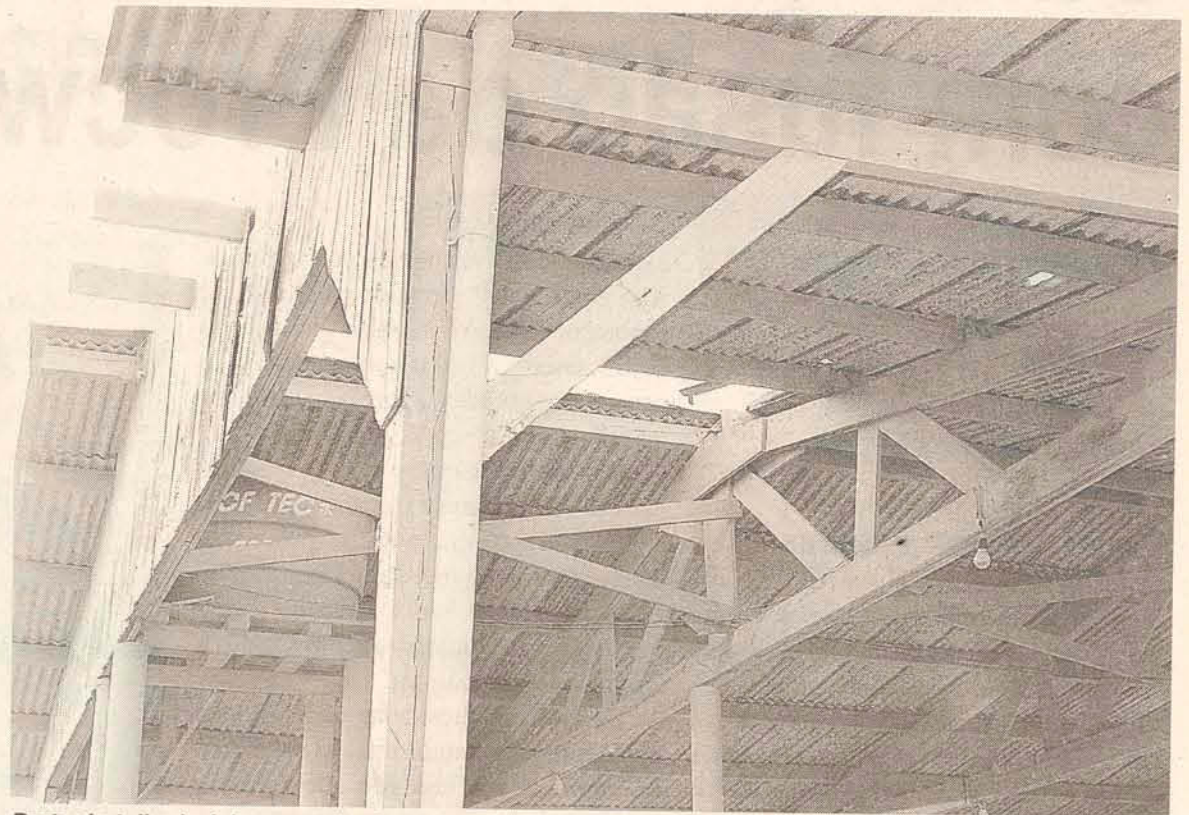
Parte do telhado foi arrancada durante uma tempestade
