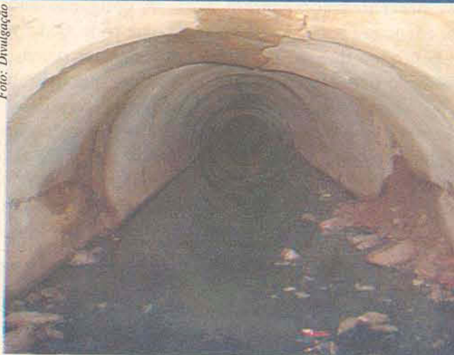
Tubulação está precária e impasse impede obra
