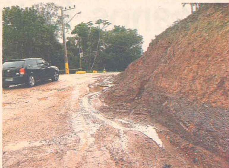
Um lamaçal se formou nas obras inacabadas em torno do hospital
