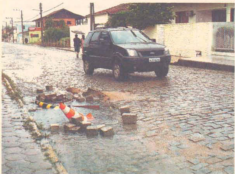
Na Rua Pedro Bonifácio Sabel um buraco jorrava esgoto
