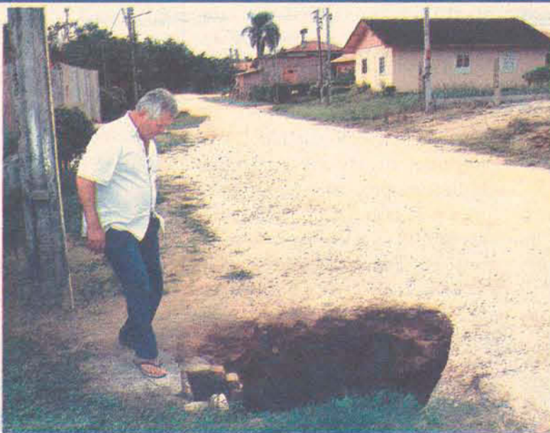
Segundo Raul Cani, a tubulação de esgoto já está sendo afetada
