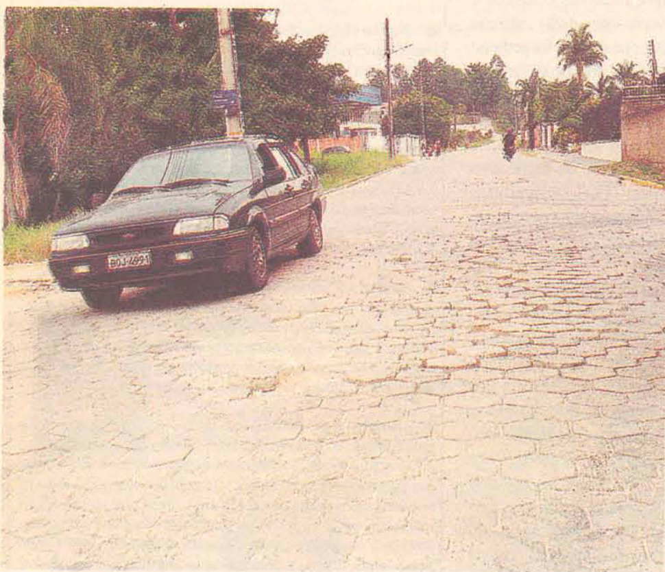
Na rua Paulo Evaldo Gaertner o calçamento está sem manutenção
