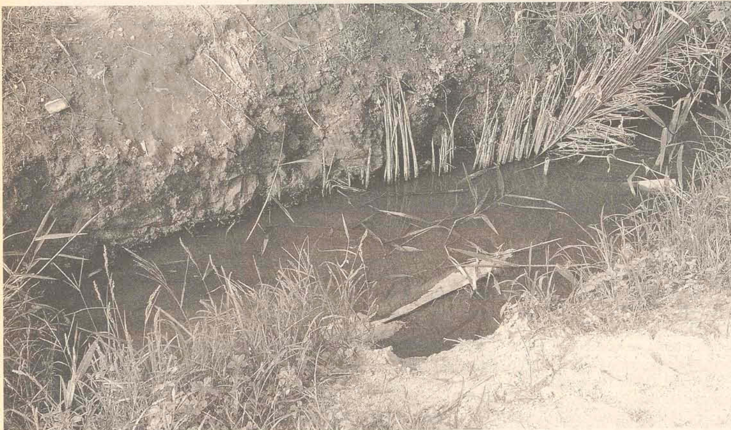
Buraco na rua Helena Gaertner oferece riscos aos pedestres e aos ciclistas que por ali passam
