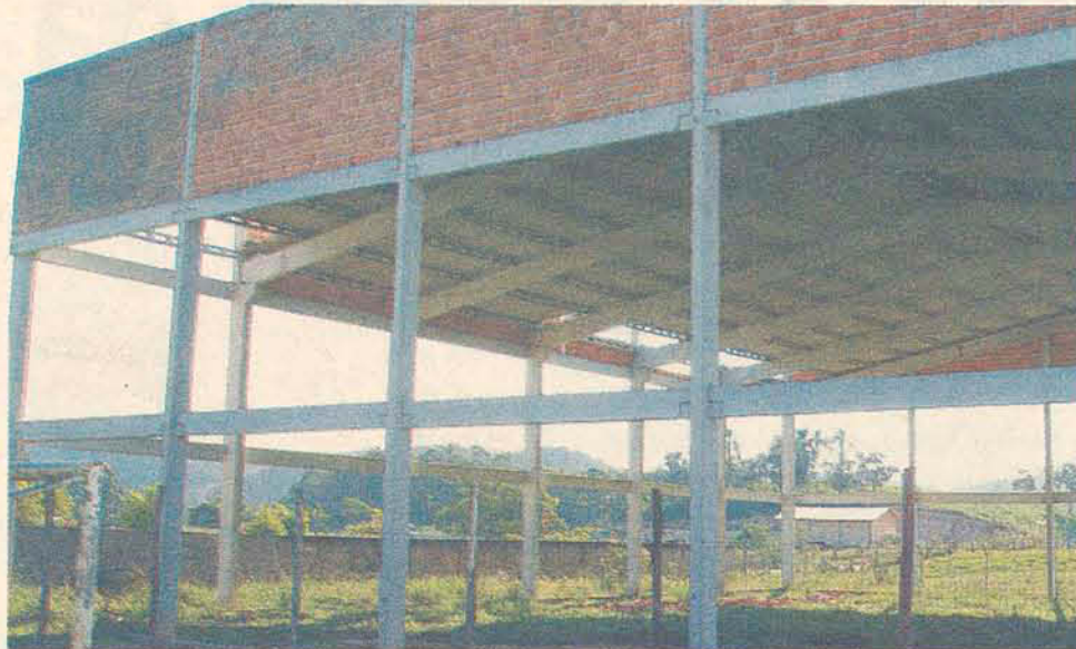
Obra foi paralisada pois não cumpria as normas de segurança
