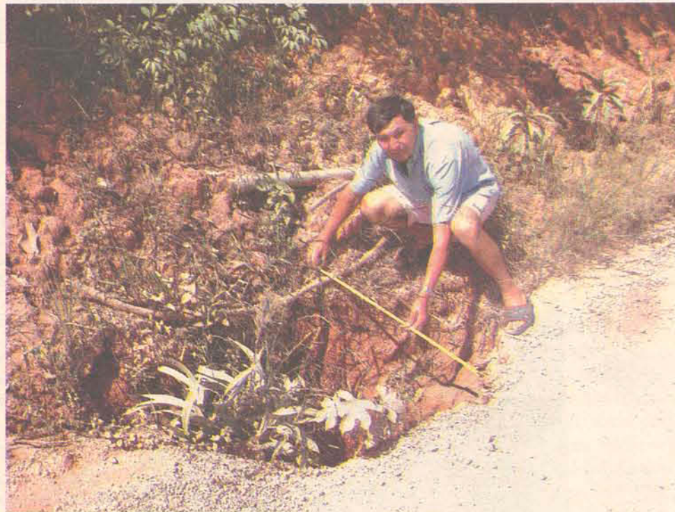
Cratera no canto da rua tem cerca de um metro de largura por um de profundidade
