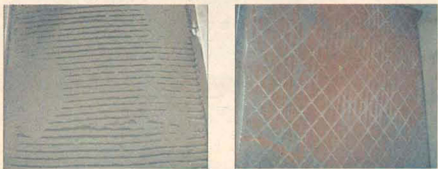
Peça sem a impregnação correta da argamassa ▲
