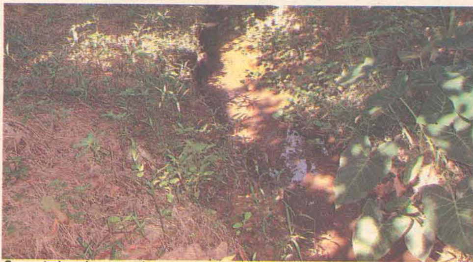
O esgoto invade a casa dos moradores em dias de chuva forte.
