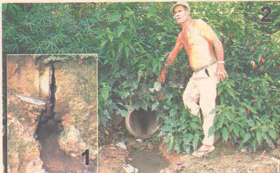
Tubulação rompida (1), esgoto desagua na rua Manoel Pedra a céu aberto (2)
