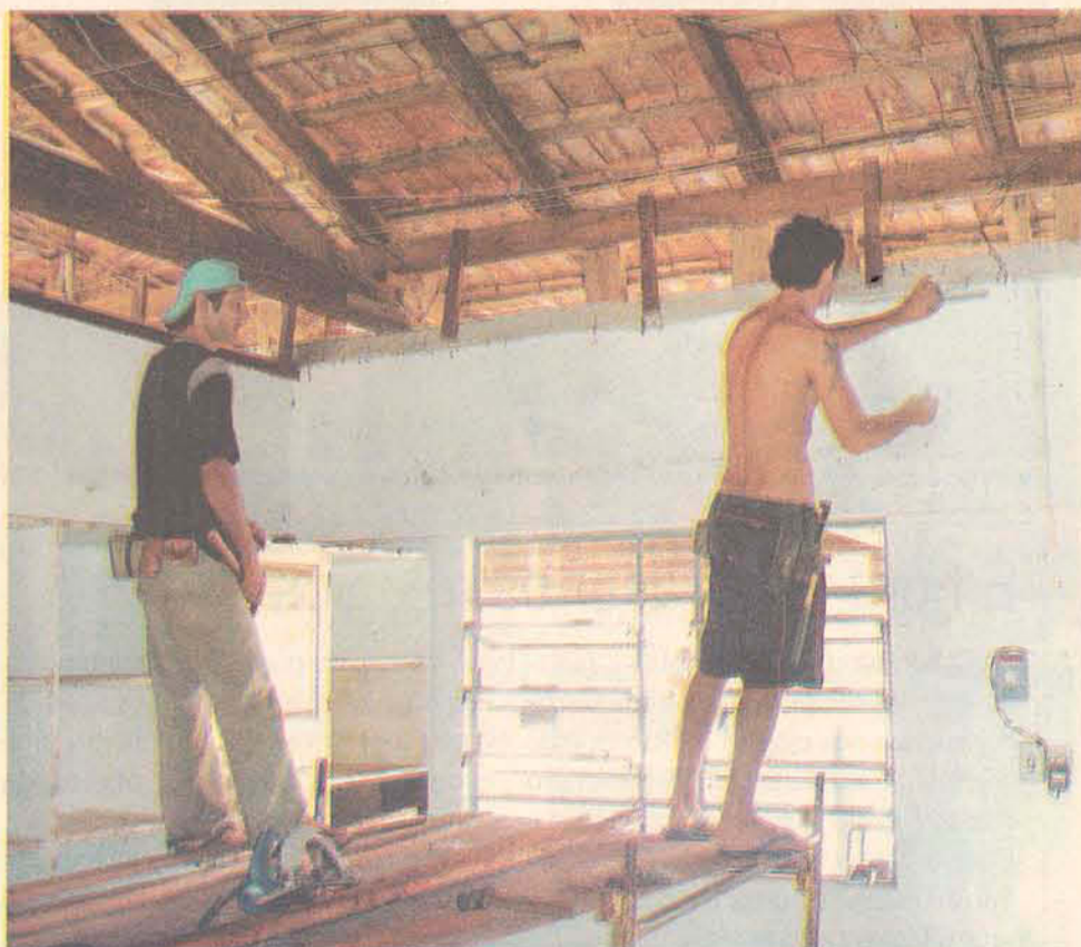
Os operários tiveram que refazer o serviço, gerando o atraso nas obras
