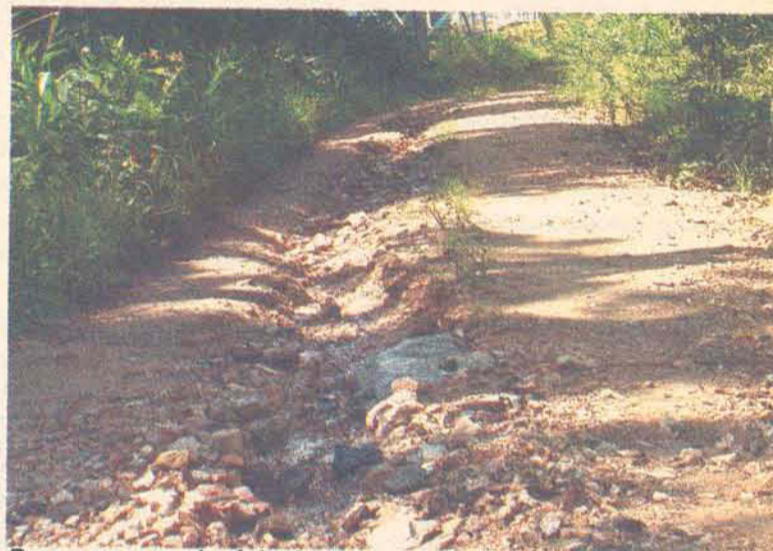
Buracos na rua José Junkes dificultam o acesso de caminhões
