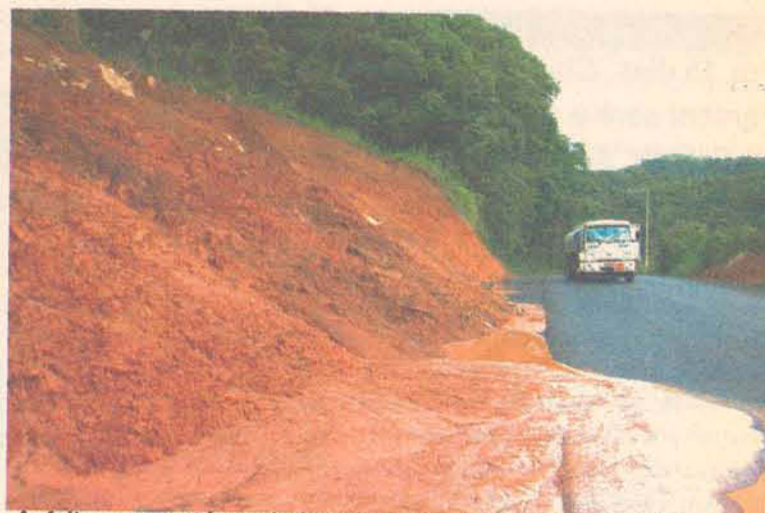
Asfalto novo está sendo invadido pelos desmoronamentos
