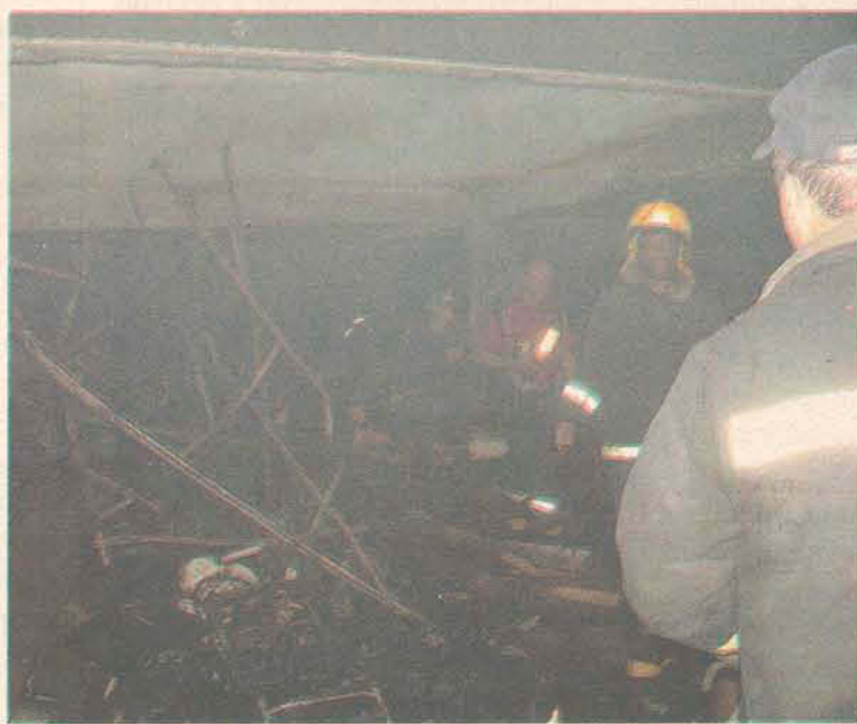
Segundo piso da loja ficou totalmente destruído
