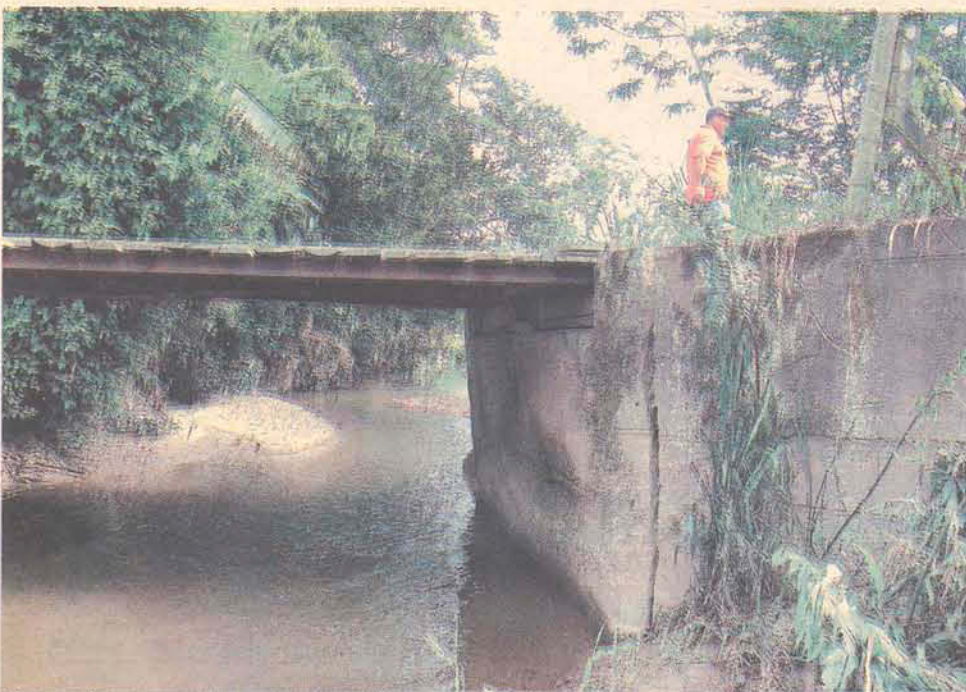
Segundo o morador, a ponte está com sua estrutura comprometida
