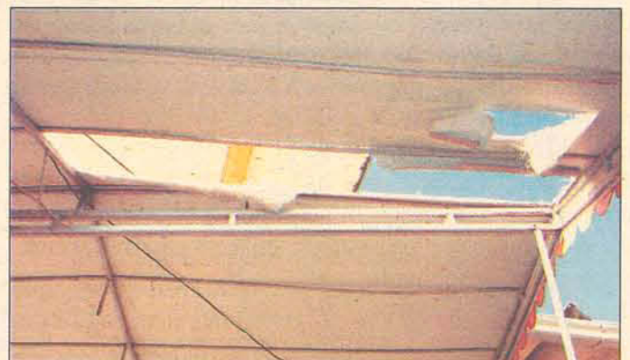
Toldo do colégio que já não estava em boas condições piorou
