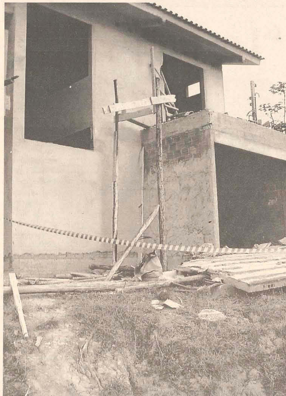
Construção desabou sobre proprietário e um pedreiro
