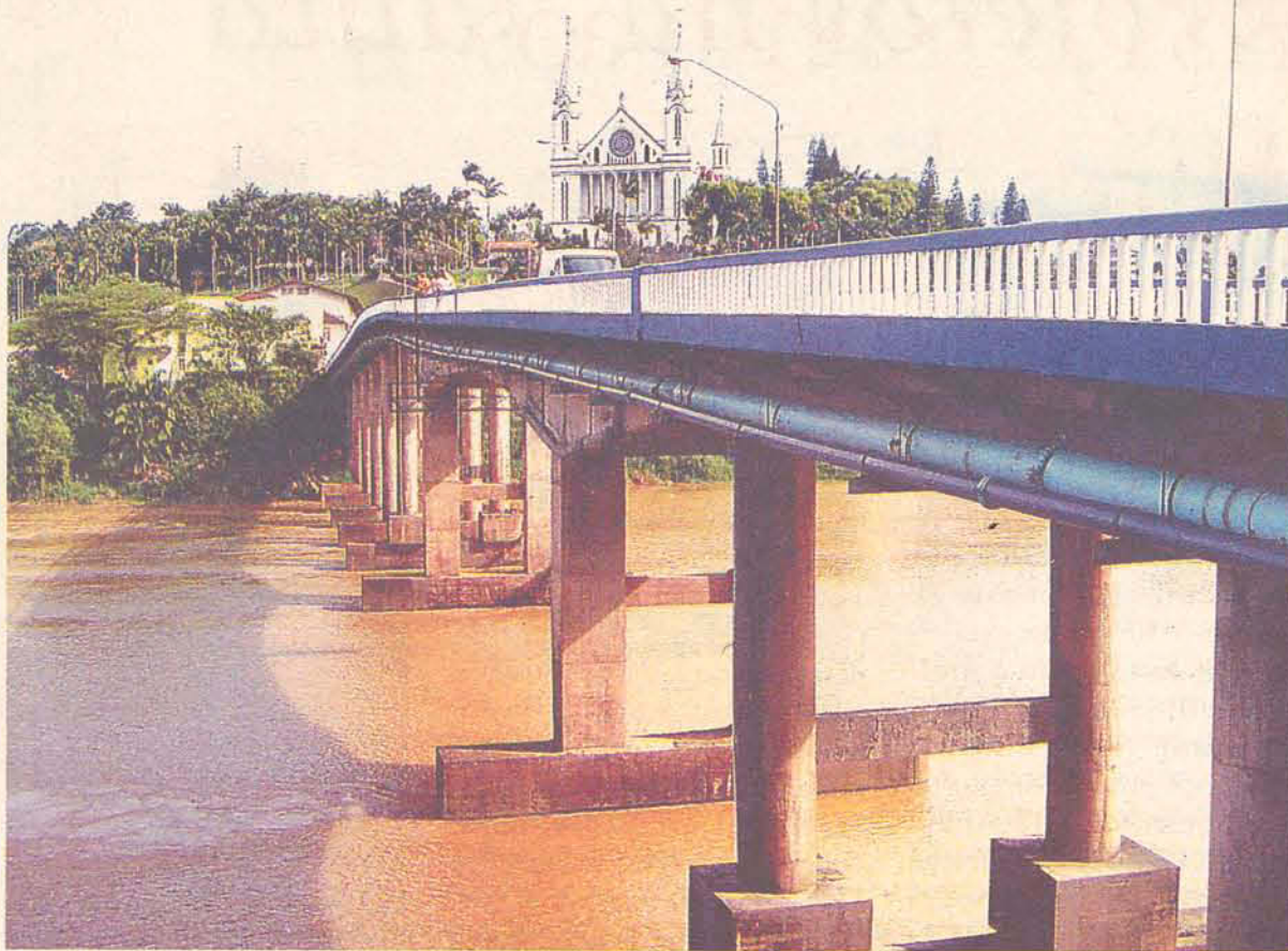
Se for recuperada e reforçada, ponte poderá voltar a suportar tráfego normal de veículos.
