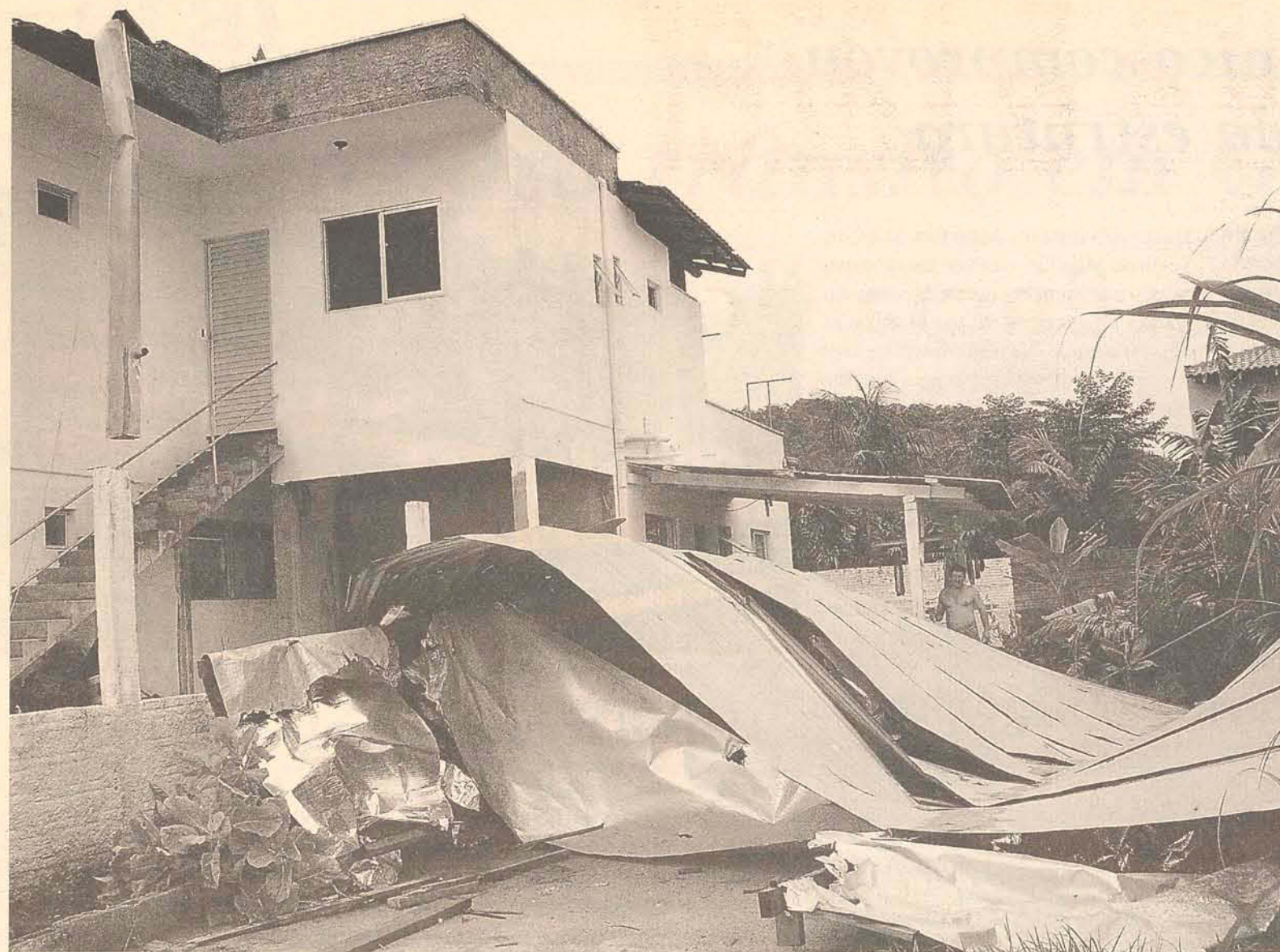
Vento arrancou telhado de alumínio da residência de Juarez, no Gaspar Grande
