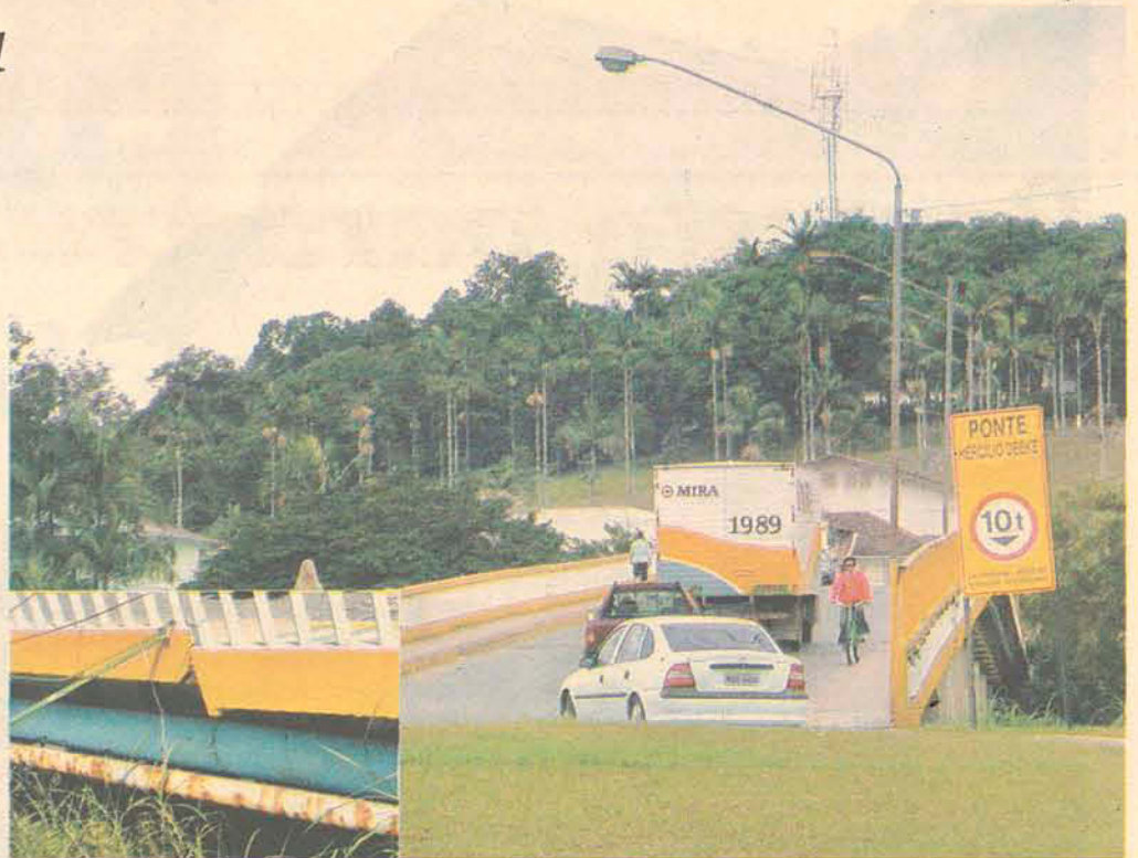
Tráfego na ponte está limitado em função de problemas na estrutura (no detalhe)
