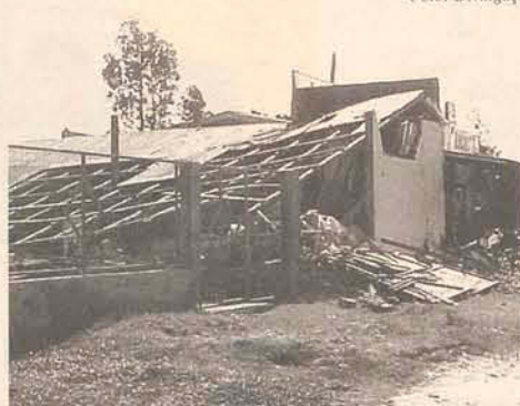
Ventos podem causar destruições
