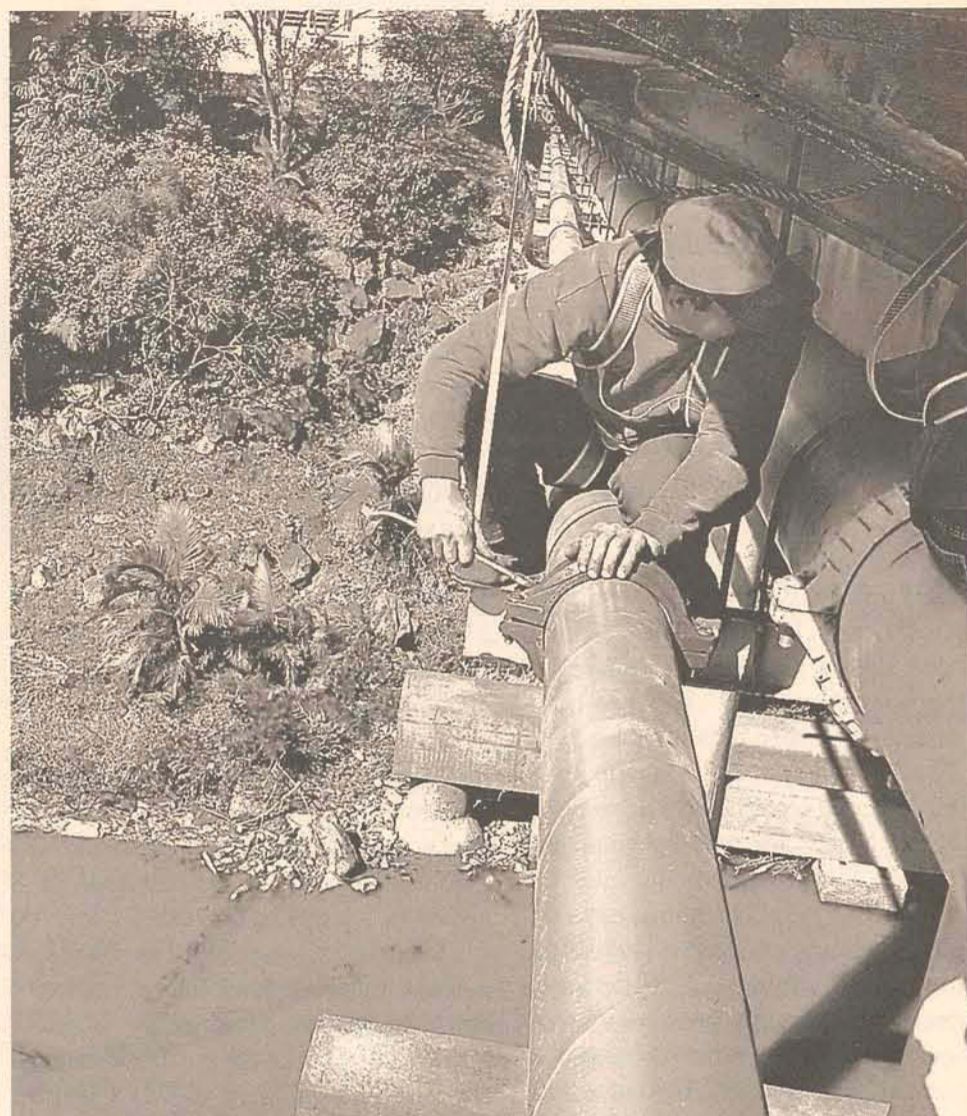
Tubulação era antiga e estava bastante deteriorada
