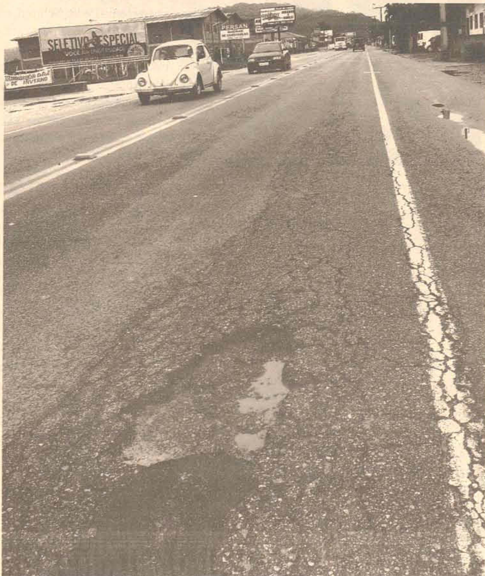
Buraco coloca em risco motoristas
