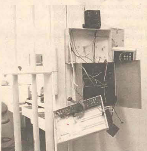
O sistema de alarme desativado
