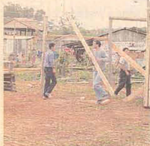
Fiscais interrompem construção de casa no loteamento atrás do Cemitério.
