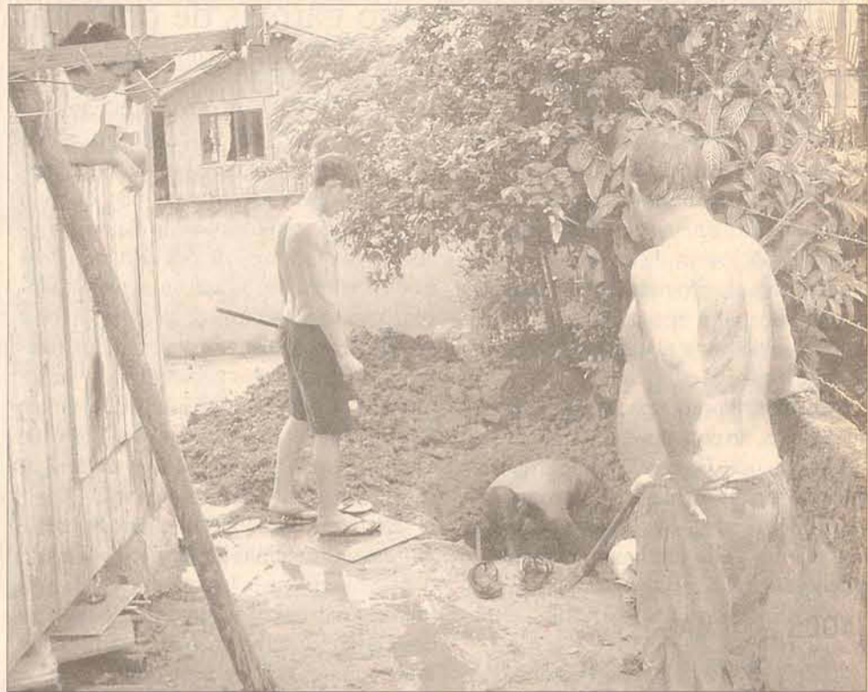
Problema com a tubulação já dura há 12 anos
