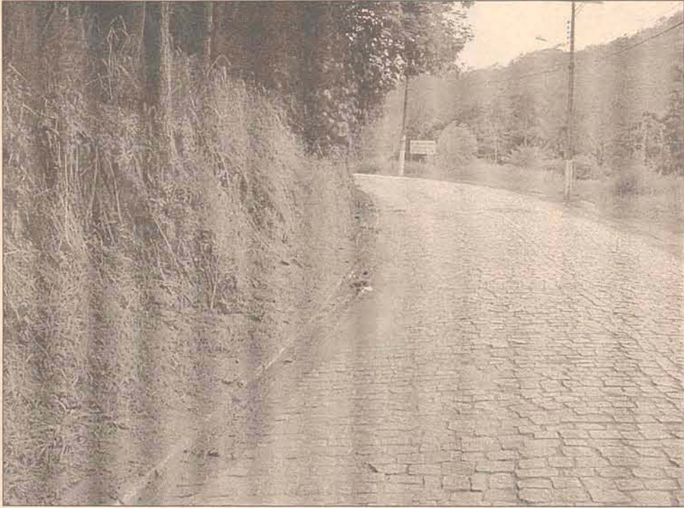
Falta de calçadas dificulta a passagem dos pedestres. Existe risco de acidente
