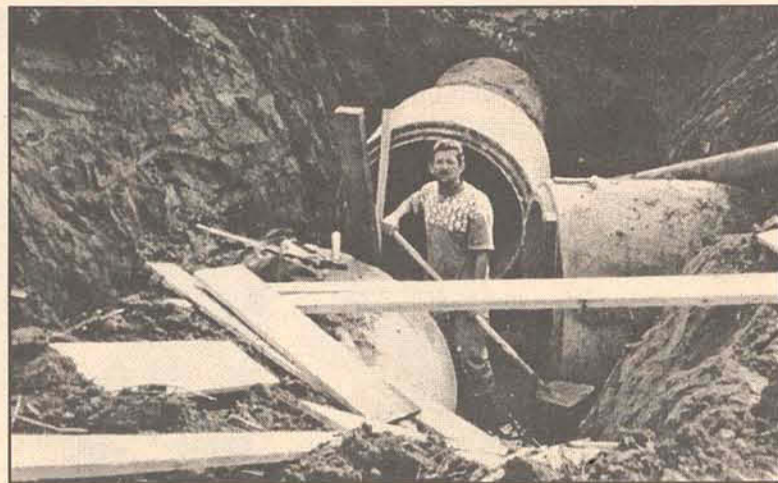
Moradores reivindicam em torno de 50 metros de tubos
