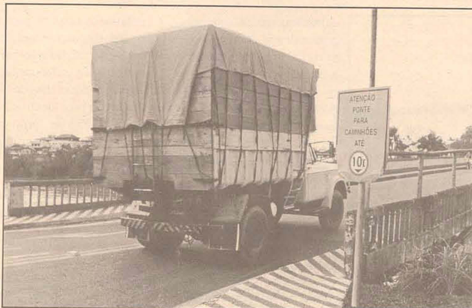
Mesmo depois da reforma da ponte a prefeitura não quer permitir os veículos pesados
